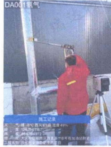
DA001 液态肥生产车间排气筒排
