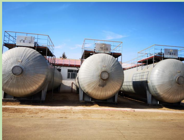
图 3.10-5 葡二联脱水站站况现状
