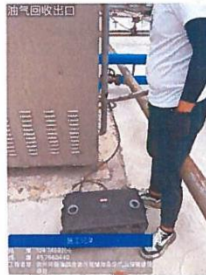
油气回收装置后
