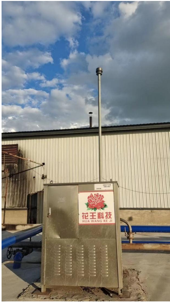
油气回收系统及排气筒
