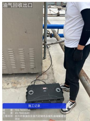
油气回收装置后
