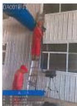
喷砂除尘废气排气筒 (DA001) 处理前
