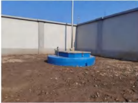
一体化雨水泵站
