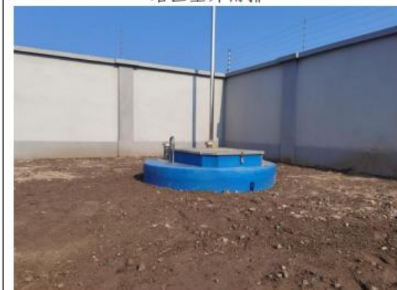
一体化雨水泵站
