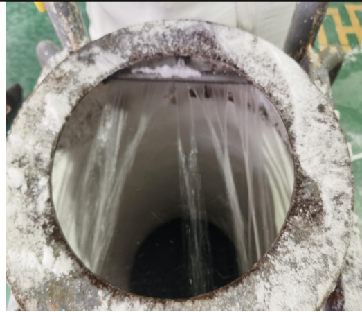
投料口喷淋装置
