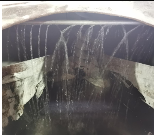
投料槽喷淋装置
