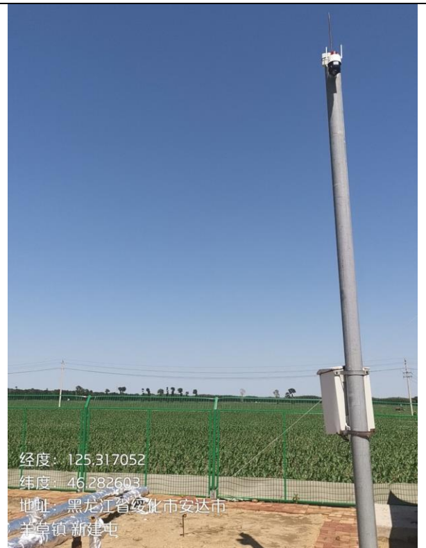
管道衔接地面场地监控系统
