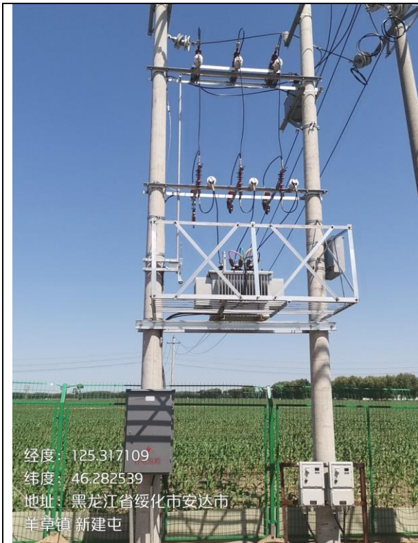
管道衔接地面场地柱上变电站
