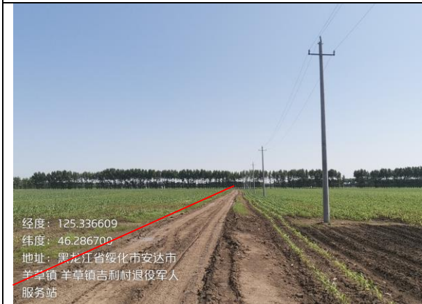
宋深 9-平 1 至衔接场地采气管线（起点段）
