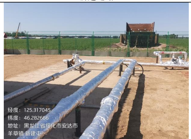
管道衔接地面场地汇管及站外放空池
