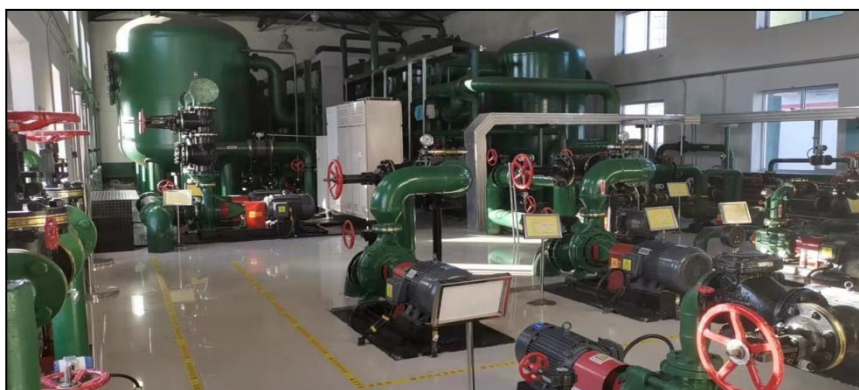
图 3.2-5 源二联地下水深度处理站现状图
