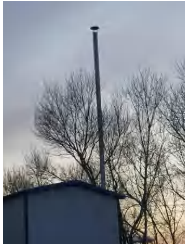
危废贮存库配套排气筒
