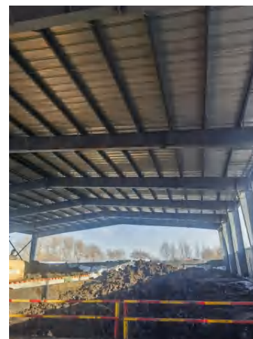
油泥暂存池可移动式罩棚及围挡
