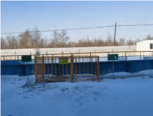
初期雨水收集池
