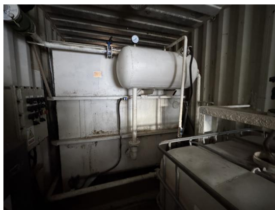
撬装废液处理装置（溶气泵）
