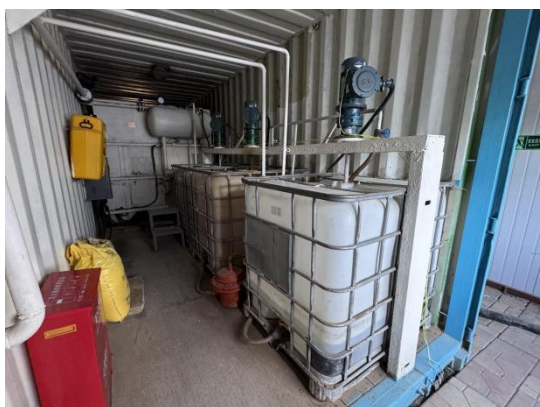
撬装废液处理装置（加药装置）
