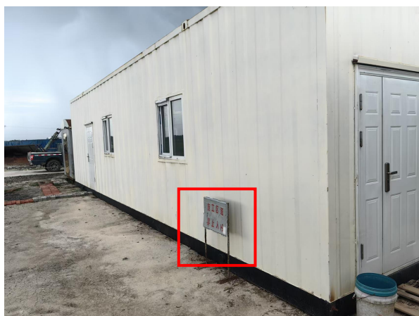
图 3-8 设备区警示牌
