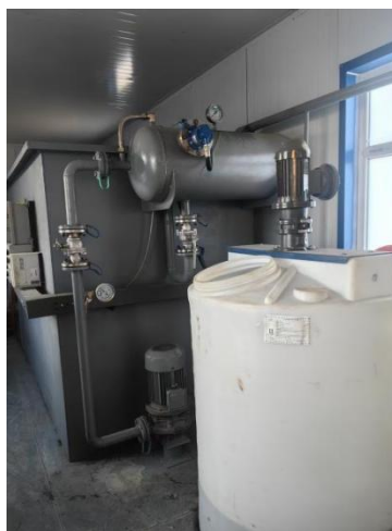
废液处理装置（加药装置）
