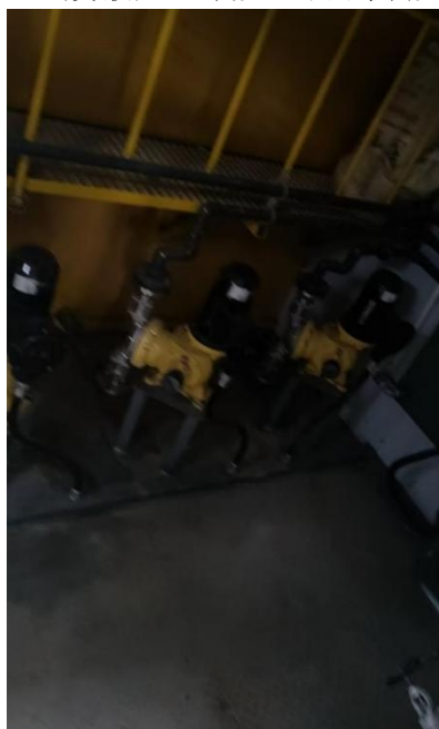
废液处理装置（加药泵）
