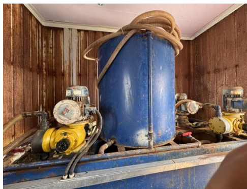
废液处理装置（加药装置）
