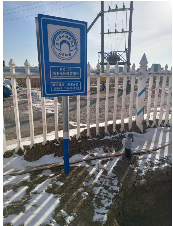
地下水监测井
