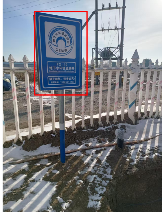
图 3-5 地下水监控井警示牌
