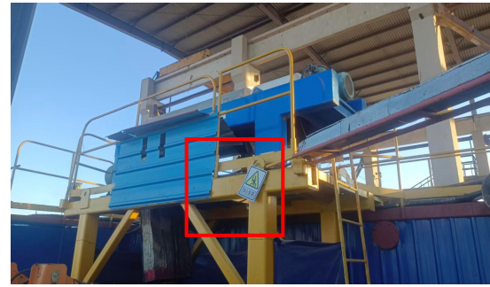
图 3-10 装置区警示牌
