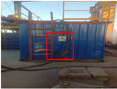
图 3-9 装置区警示牌
