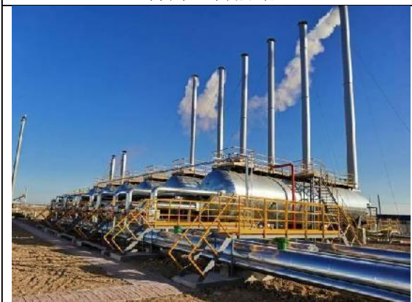
聚杏四-I 转油放水站
