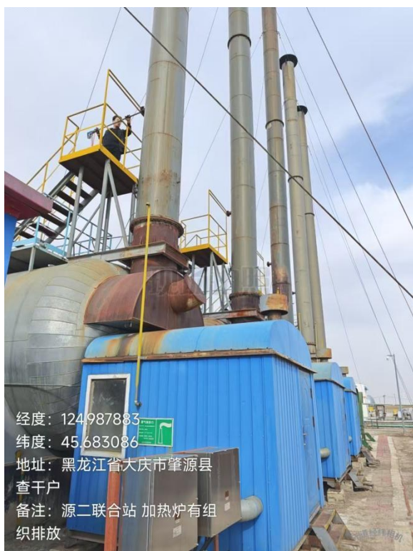
源二联合站内加热炉
