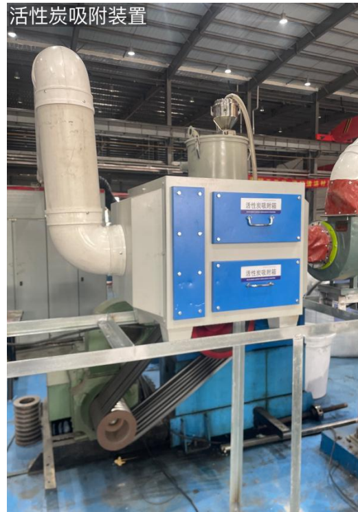
活性炭、过滤棉
